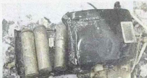
图 4-1-27 多个电池并联充电电流不一致导致的过热损坏
